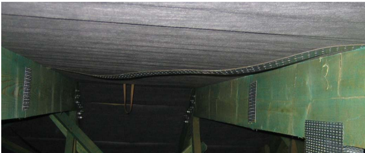
Obr. Nesprávna realizácia zavetrenia pomocou pásovej ocele
