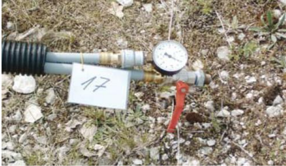
Obr. 8: Osazení jednotky pro zkoušení tlaku
