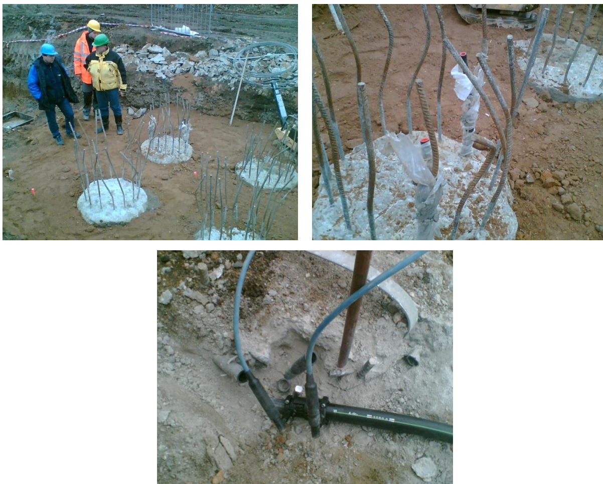
Obr. 13: Potrubí přívodu a odvodu v hlavě energetické piloty
