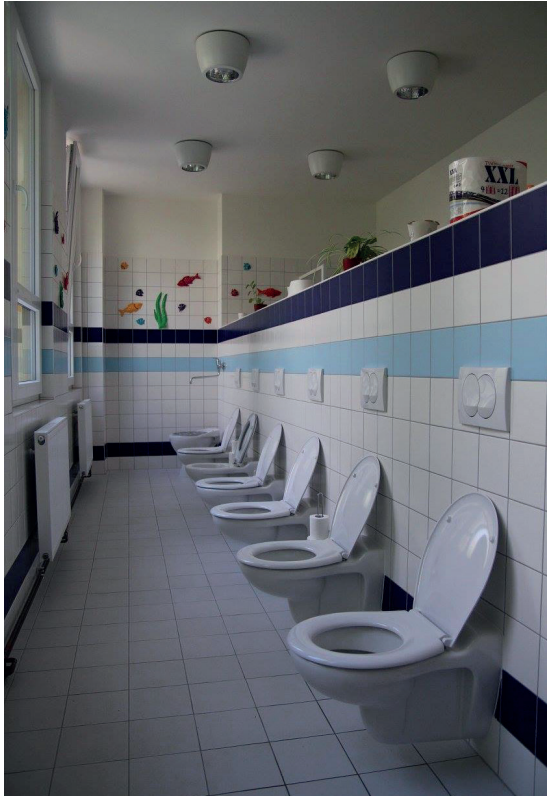
obr. 11.13 CPV Bolevecká, umývárna / archiv autora
