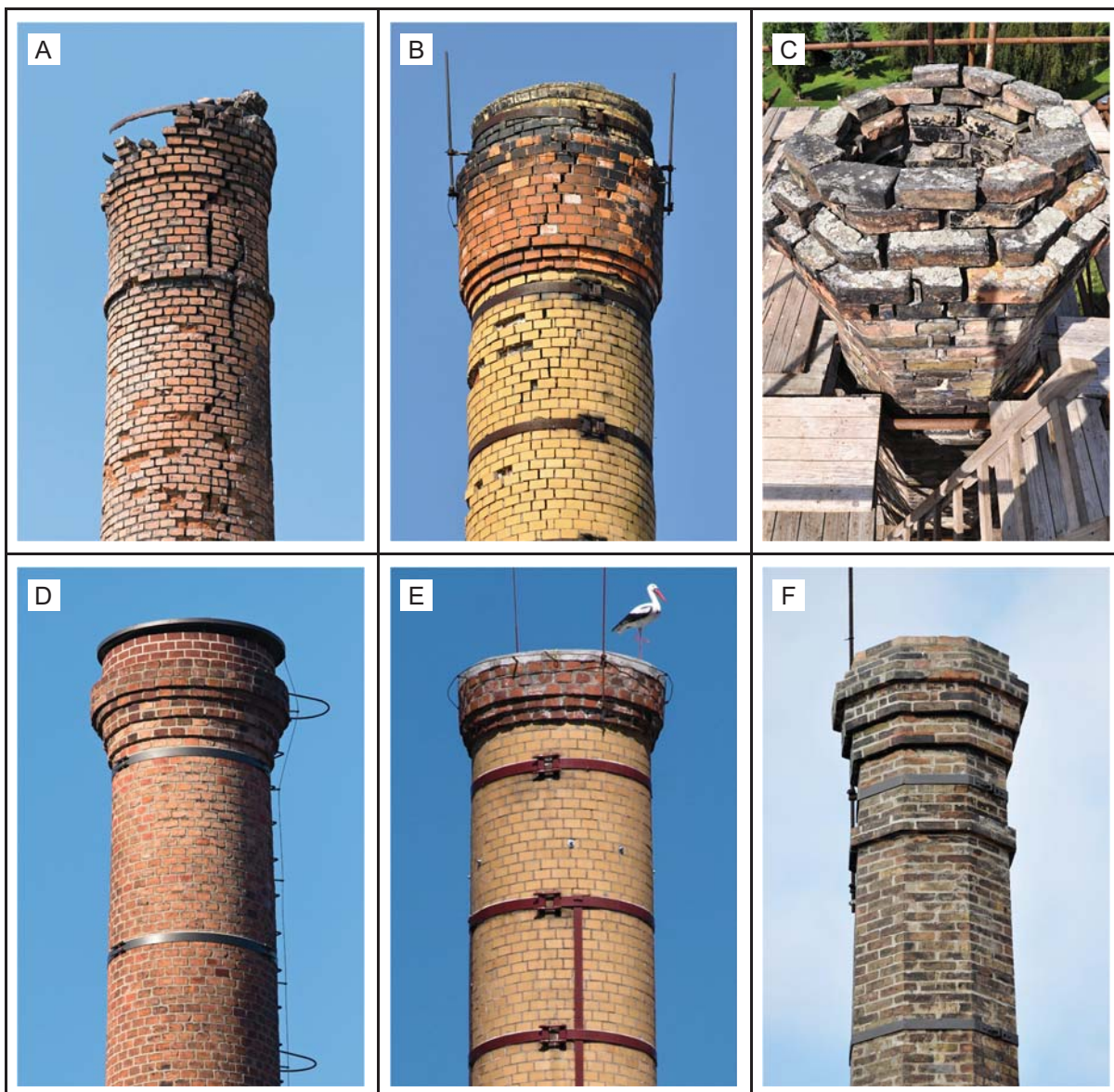
Obr. 75: Méně obvyklé přístupy v opravách horních částí dříků. A a D: Snesení několika metrů poškozeného dříku a vyzdění podobně vypadající hlavice ze zachovaných cihel, vypadaná místa vyplněna maltou a natřena, horní vrstvy zdiva nad římsou jsou namalované na železobetonovém věnci (nová výška komína je o něco nižší než původní). Cihelna, František Hennlich, Strupčice (→ 1792). B a E: Snížení poškozeného dříku a vyzdění drobného rozšíření cihlami získanými z demolice jiného komína. Továrna na barvy, Břasy (→ 602). C a F: Přístup v rámci kulturní památky – kompletní přezdění hlavice do původní podoby, doplnění narušených míst novými cihlami s důrazem na podobný odstín, stažení dříku novými obručemi. Pivovar, Lobeč.
