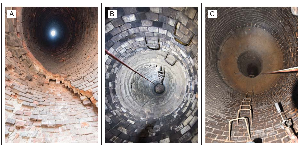
Obr. 45: Ochranná pouzdra. A: Cukrovar, Čelechovice na Hané (→ 181). B: Městská elektrárna, Horní Jiřetín (→ 75). C: Textilní továrna, František Procházka, Humpolec (→ 637).
