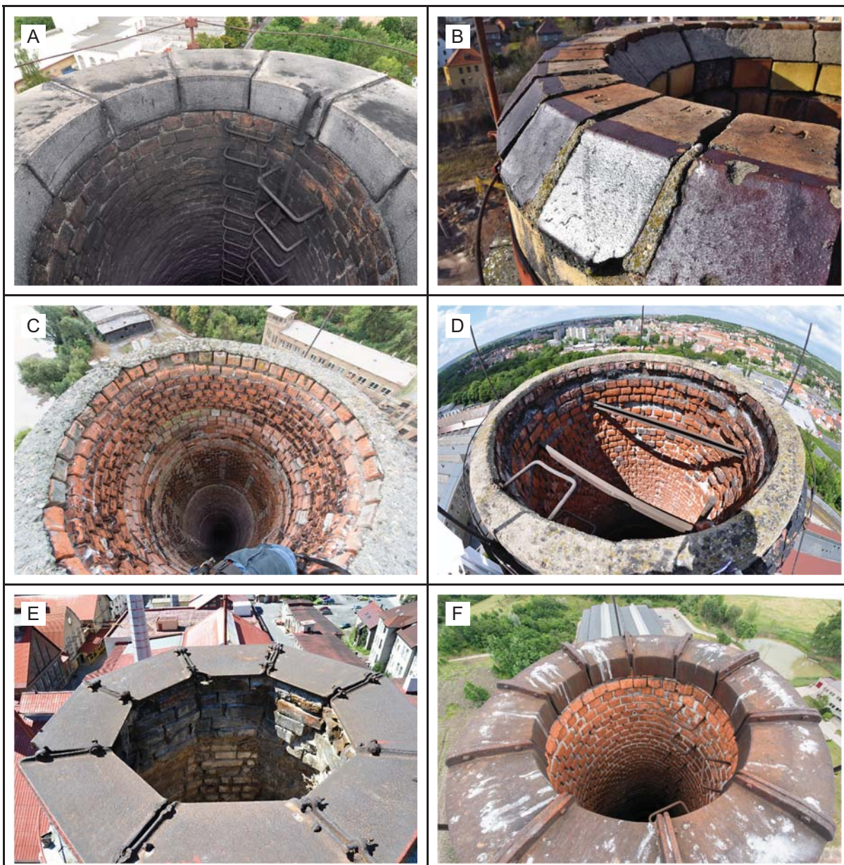
Obr. 37: Materiálové řešení hlav komínů. A: Kamenné bloky. Kanalizační čistírna odpadních vod, Praha 6-Bubeneč (→ 405). B: Tvarovky. Dřevozpracující podnik. Děčín-Nové Město. C: Betonová mazanina. Přáderna bavlny, Stein, Roztoky (→ 324). D: Betonová mazanina, v průduchu osazeny ztužující ocelové profily. Strojírny, Slaný (→ 24). E: Kovové segmentové desky. Sklářny, Desná (→ 432). F: Litinové segmenty (typická produkce n. p. Teplotechna). Cihelna, Dětenice-Osenice.
