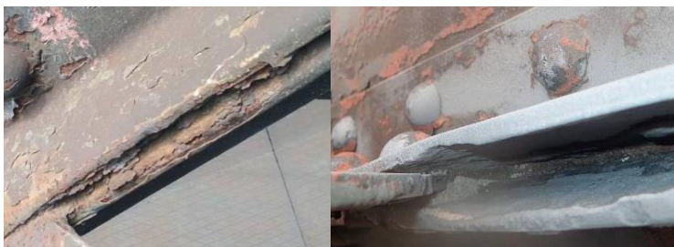
Obr. 11 Prokorodování diagonály před a po čištění, železniční most pod Vyšehradem
