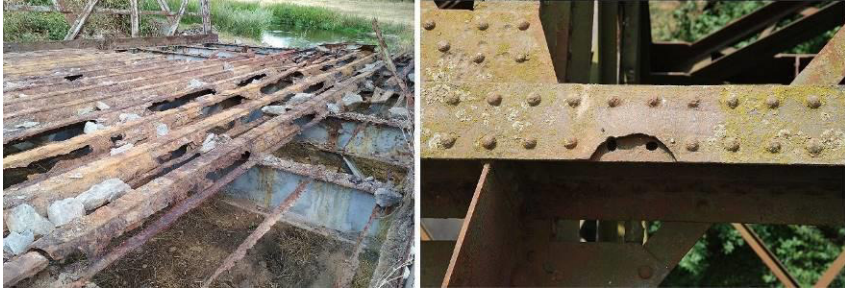
Obr. 7 Vybrané poruchy ocelových mostů: vlevo – korozie mostin „Zorés“ na mostě v Pamětníku, vpravo – trhliny v pásnici podélníku v detailu plošného uložení mostnic
