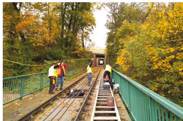
Zavlákání optovláknového inklinometru do opěry mostu
